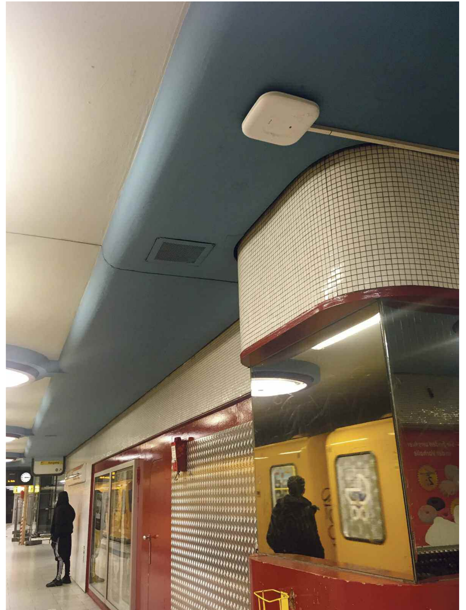
In vielen Berliner U-Bahnhöfen hängen kleine weiße Kästen, die sogenannten Access Points der BVG, die WLAN in die Stationen bringen.
