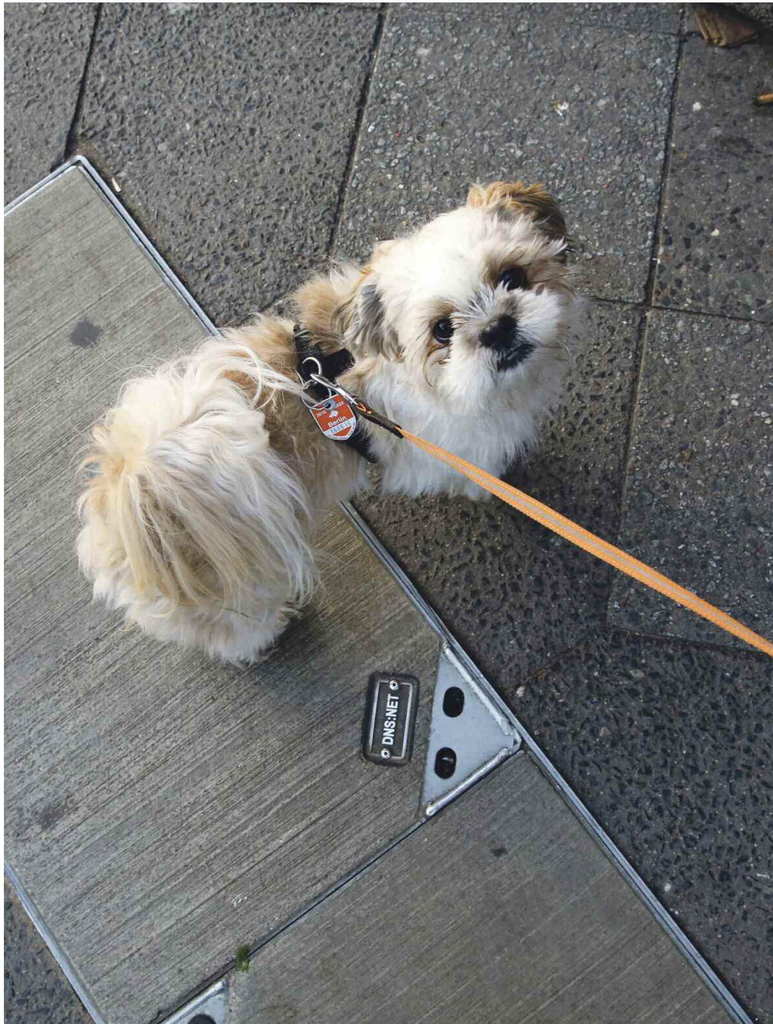
In der Bildstrecke in diesem Heft machen wir das Internet in der Stadt sichtbar. Die Schächte für Glasfaserkabel verlaufen von uns fast unbemerkt überall durch Berlin.
